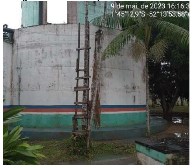
Figura 22: RAP 01 capacidade de 250 m 3
