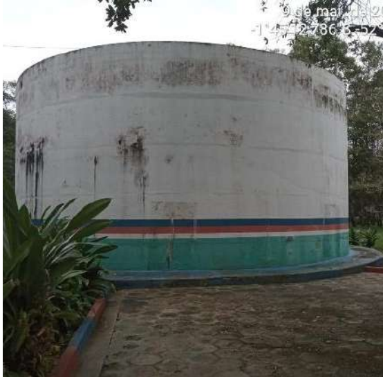
Figura 23: RAP 02 capacidade de 250m 3
