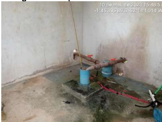
Figura 18: Poço 1 do Bairro Maturu
